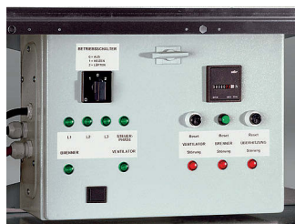
Встроенный распределительный шкаф
